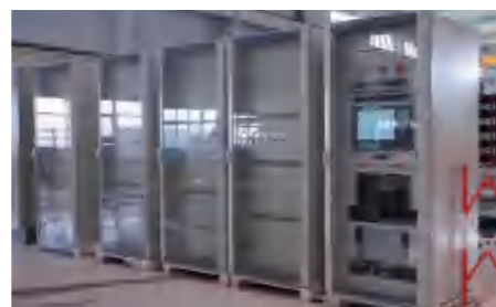
Fig. 4 SVG on-site photos (control cabinet)
